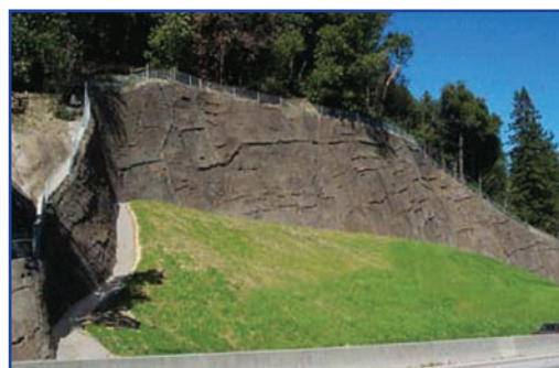
Ejemplo de contención de talud de carretera mediante sistema INGEONAIL y acabado estético
